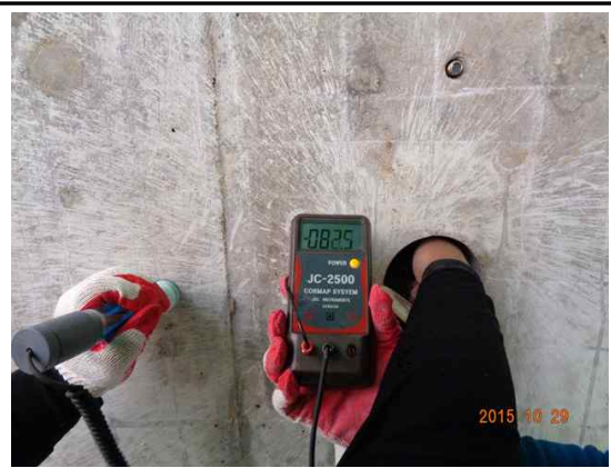
위 치 교각 내 용 철근부식도 측정현황
