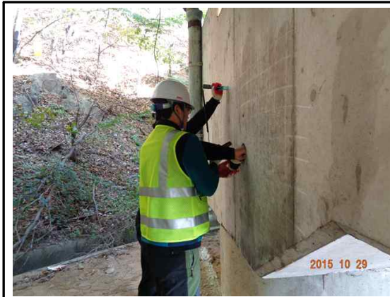
위 치 교각 내 용 철근부식도 측정현황
